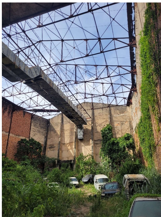
Figura 10: Escombros do Cine Rio Palace
