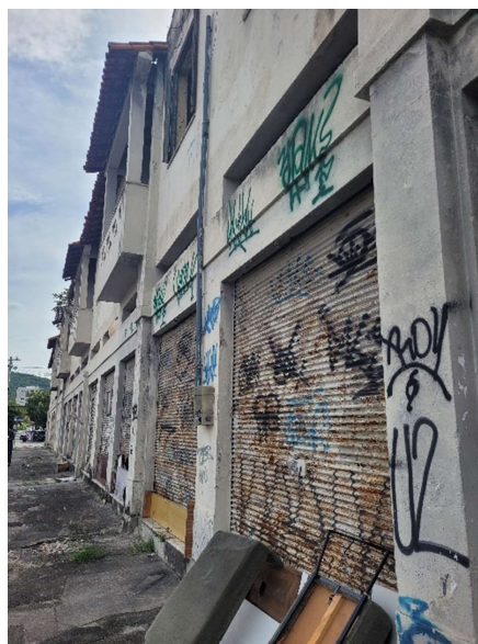
Figura 8: Lateral da ruína do Cinema Olaria
